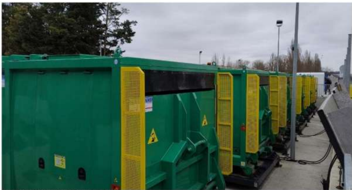
La nouvelle déchetterie compte six compacteurs G.F./RSM77
