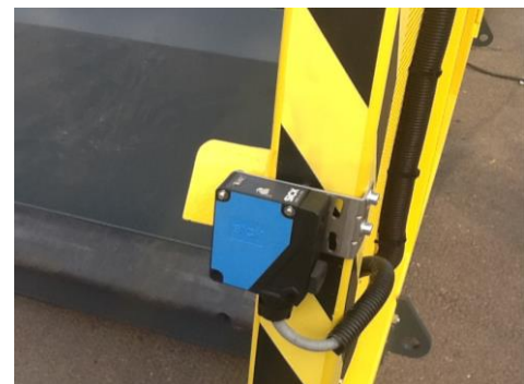
• Barrière immatérielle de sécurité
